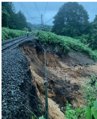
7月31日撮影：翁島～磐梯町駅間 盛土崩壊箇所 (写真手前：郡山方面、奥：会津若松方面)
